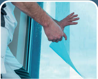
For vindu og glass
